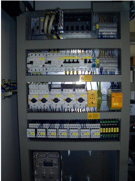
Bild 4: Schaltschrank mit erneuerter Hardware
